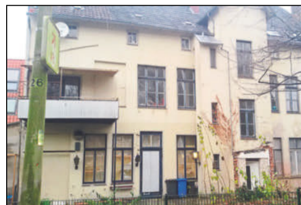
Blick auf die Rückseite des Hauses unmittelbar vor der Renovierung. Fotos: (2) Jana Budek
