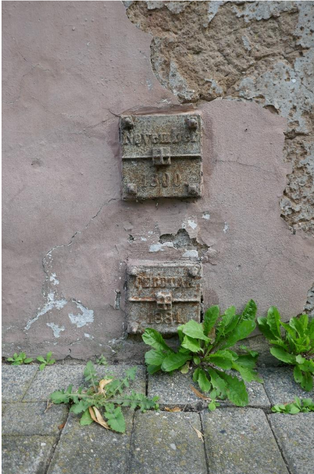
Abbildung 1: Komturstraße 29. Hochwassermarkierung vom Februar 1881 und November 1890. (Foto Mathias Polster)
